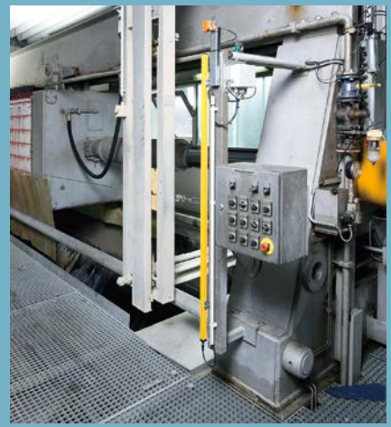
箱式压滤机的安全监测
