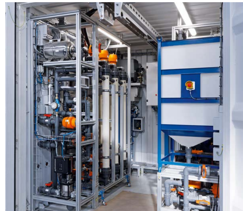
整个水处理系统被集成在紧凑型集装箱中。
